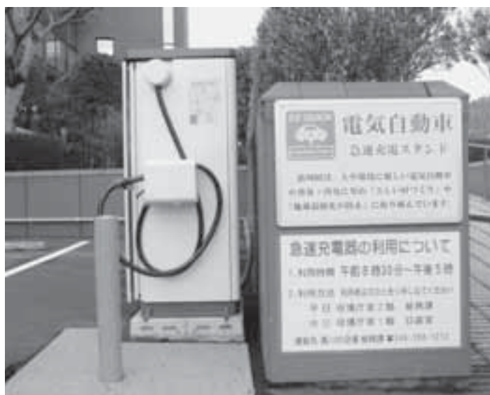
役場敷地内に設置されている電気自動車用の急速充電スタンド
